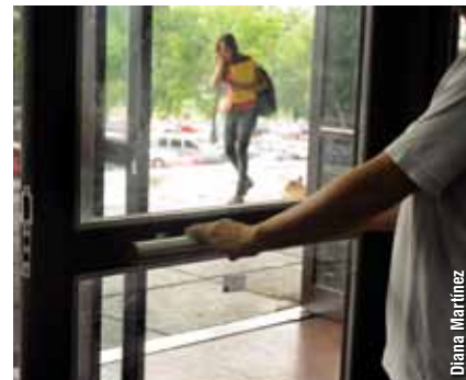
Detalle de la barra de empuje correspondiente a las puertas de ingreso del Pabellón II.
