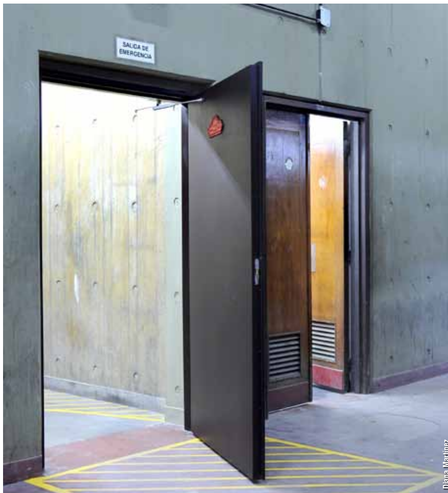
“Las nuevas puertas de las escaleras de emergencia del Pabellón II, son puertas corta fuego que soportan altas temperaturas durante un lapso de tiempo importante. Están aprobadas por el INTI y son de muy buena calidad, indica Svarc”.
